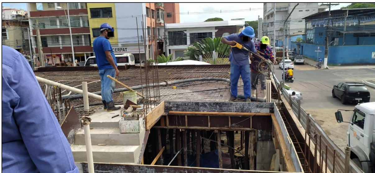
Figura 2 – Trabalhadores usando os EPIs de forma incompleta (sem luvas, óculos, sapato, etc.)
