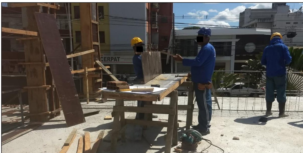
Figura 3 – Uso de serra circular sem proteção adequada
