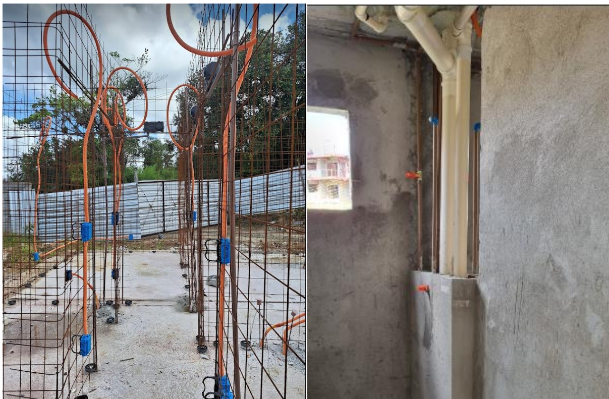
Figura 2: Instalações elétrica e hidráulica
