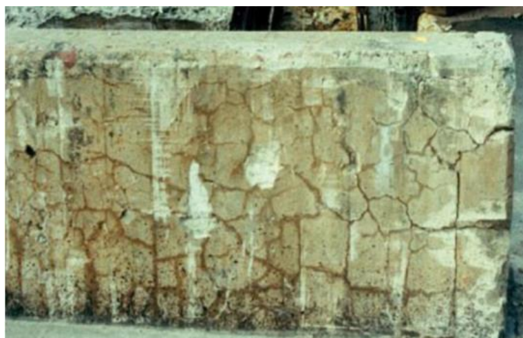
Figura 03: Reação álcali-agregado em bloco de concreto
