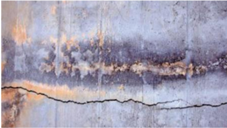
Figura 02: Fissuração de bloco de fundação pr expansão por sulfato
