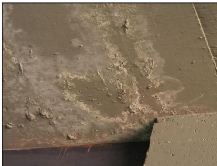
Figura 01: Processo de lixiviação com manifestação patológica de eflorescência na Laje 7 – Cobertura – Pav. Administrativo da Organização Militar do Exército em Brasília – DF.
