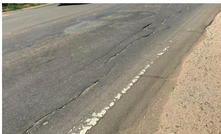
Figura 08- Trincas longitudinais curtas e longas na BR 415.
