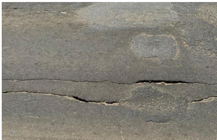
Figura 07- Trincas transversais curtas na BR 415.
